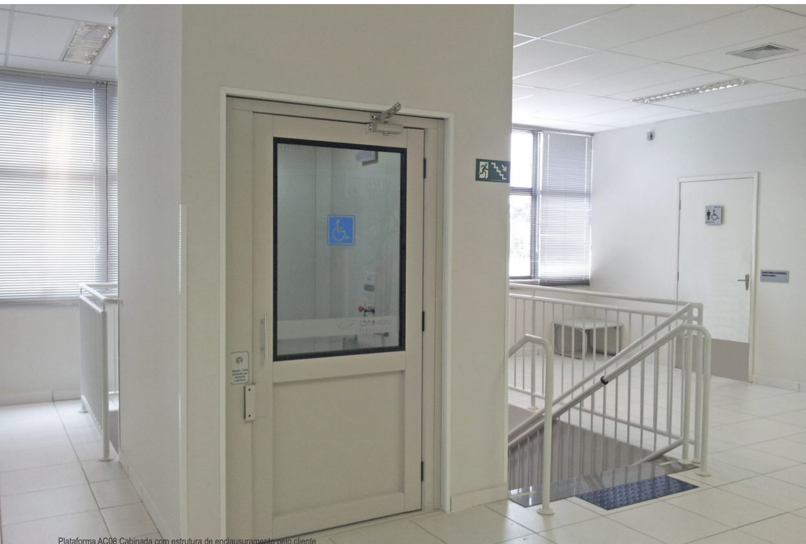
Plataforma AC08 Cabinada com estrutura de enclausuramento pelo cliente
