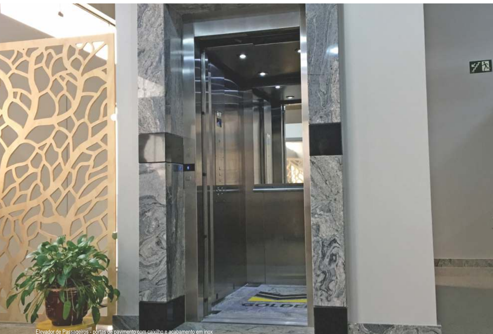
Elevador de Passageiros - portas de pavimento com caixilho e acabamento em inox
